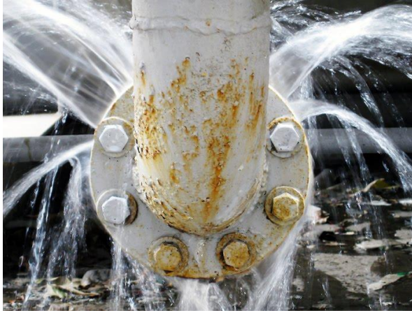
Gambar 2.3 Aliran pipa yang mengalami kebocoran (sumber : google.com)
